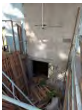
Vstupní nádrž to tech suterénu
