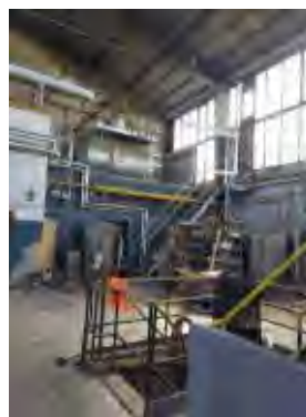
Ohřev teplé vody
