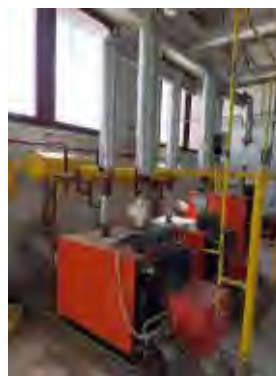
Kotelna objektu "Gala"
