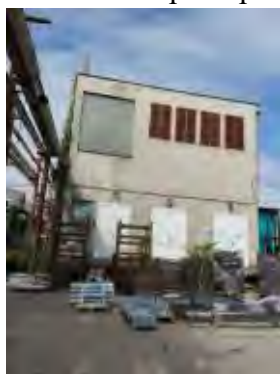
Trafostanice, parc.č. st. 1712
