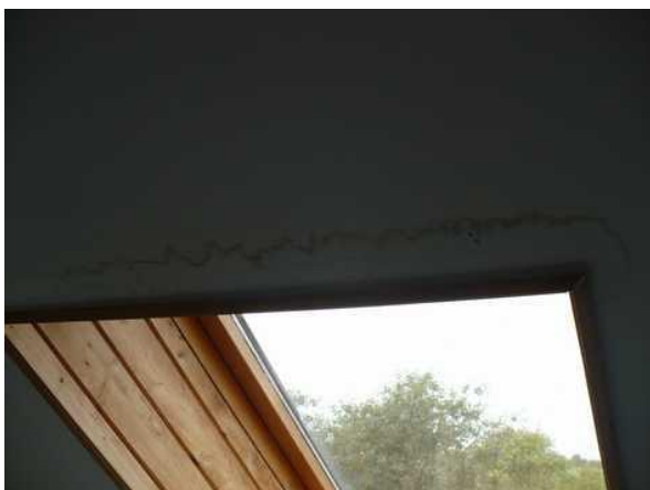
zatékání kolem střešních oken
