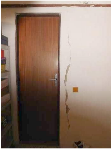
poškozené vnitřní příčky
