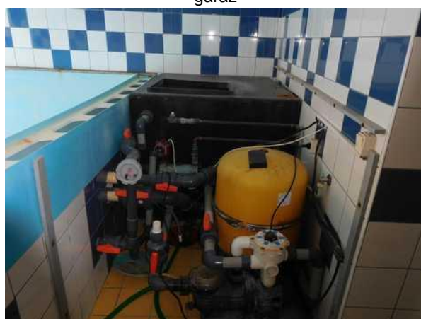
filtrace a úprava vody
