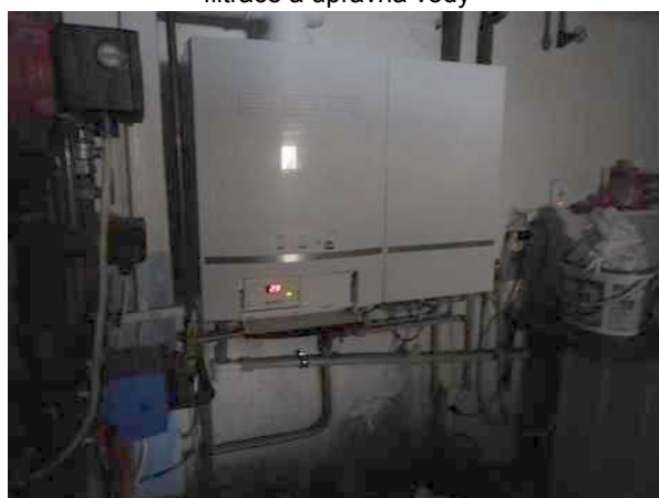
plynové kotle ÚT
